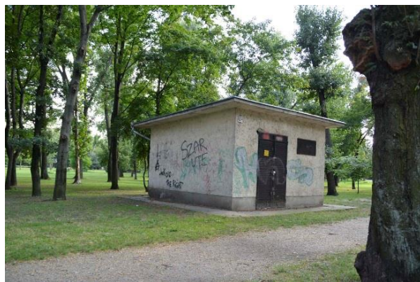
Építettház 10/0,4 kV transzformátor
