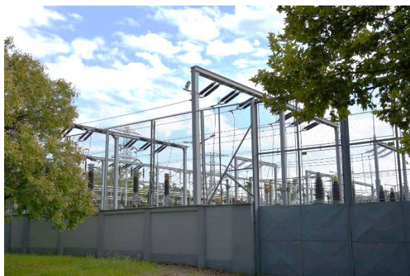
A Népligetben található elektromos alállomás
