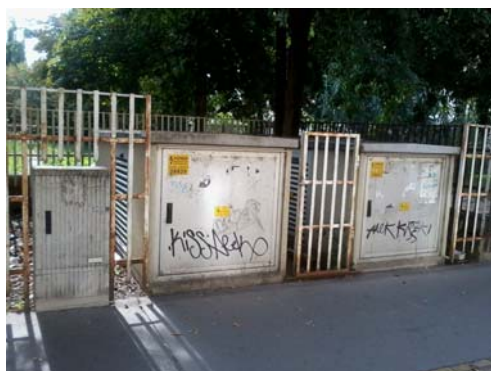
8829 és 8827 sz. 10/0,4 kV-os betonházas transzformátorok
