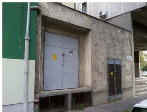
7505 sz. 10/0,4 kV-os épületben elhelyezett transzformátor
