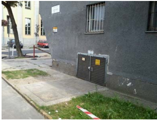
3443 sz. épületben elhelyezett 10/0,4 kV-os transzformátor
