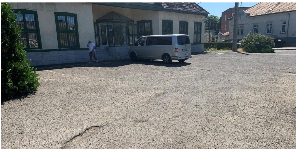
18. ábra: Az aszfalt burkolat kis felületen sérült és repedezett
