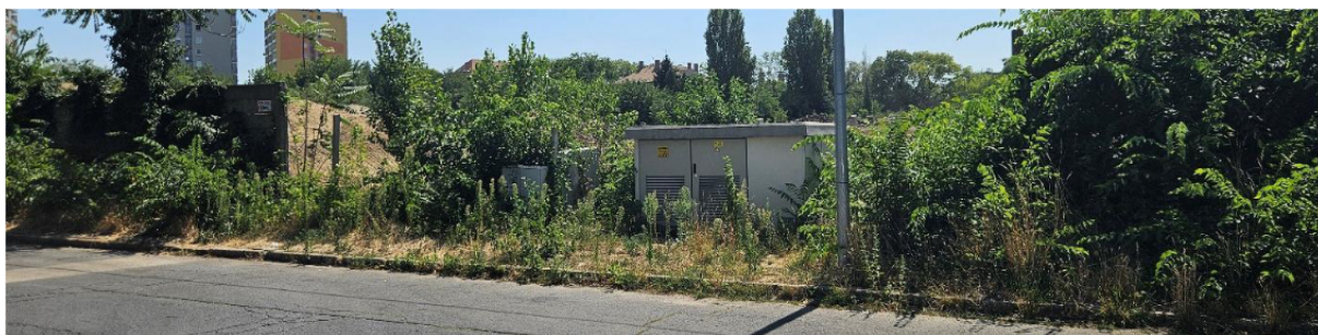
A tömböt határoló mádi utcában utcaszintben elhelyezett transzformátor műtárgya található.
