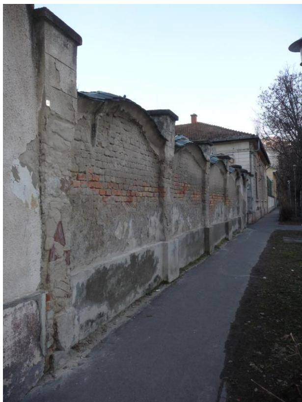
103. A kerítésfal kifelé dőlése a külső oldalon
