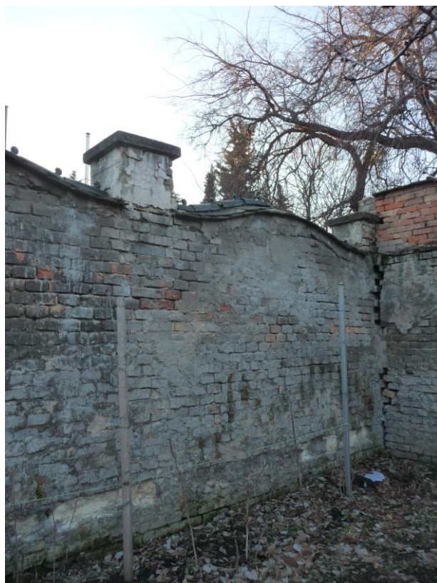
104. A kerítésfal kihúzódása a belső falsarokban
