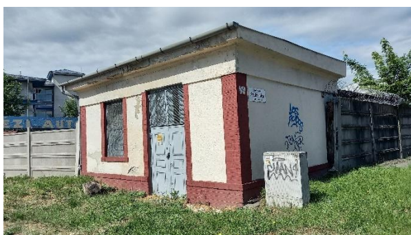
Kőér utca 3/d. szám melletti trafóház
