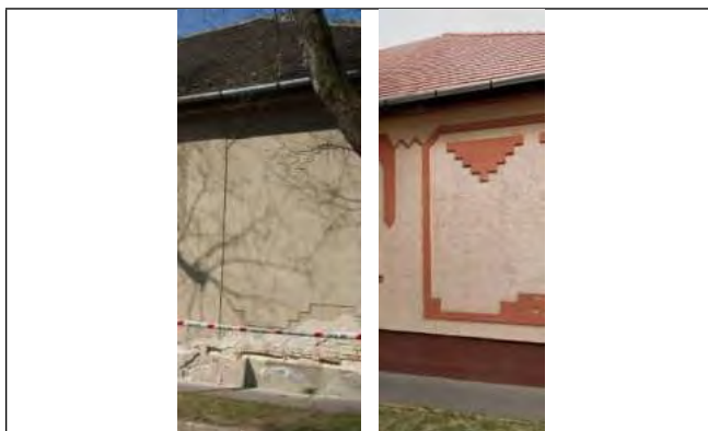
Homlokzati díszítés elnagyolt felújítása
