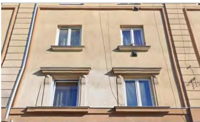
3. emeletről eltűntek a szemöldökpárkányok a felújítás során, a kicserélt ablakok nem egységesek
