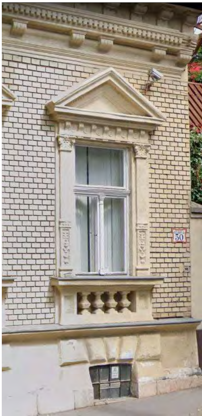
Eredeti nyílászáró belső spalettával
