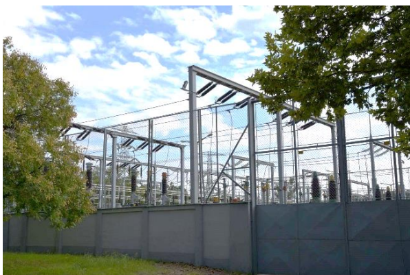
Népliget 120/10 kV alállomás
