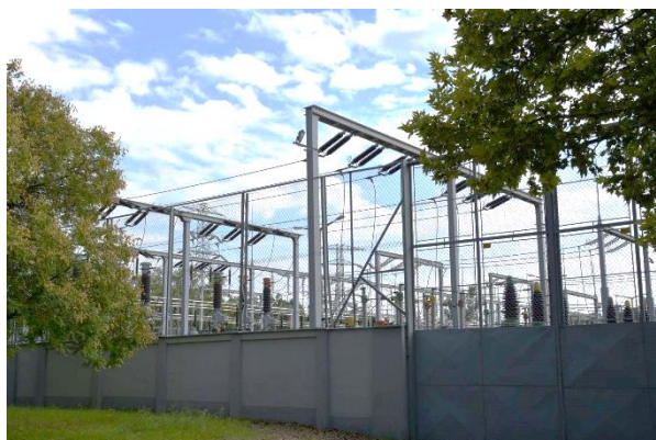
A Népligetben található elektromos alállomás
