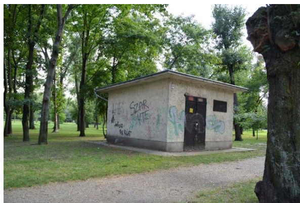
Építettház 10/0,4 kV transzformátor
